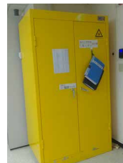
存放列管毒化物的防爆抽氣櫃
